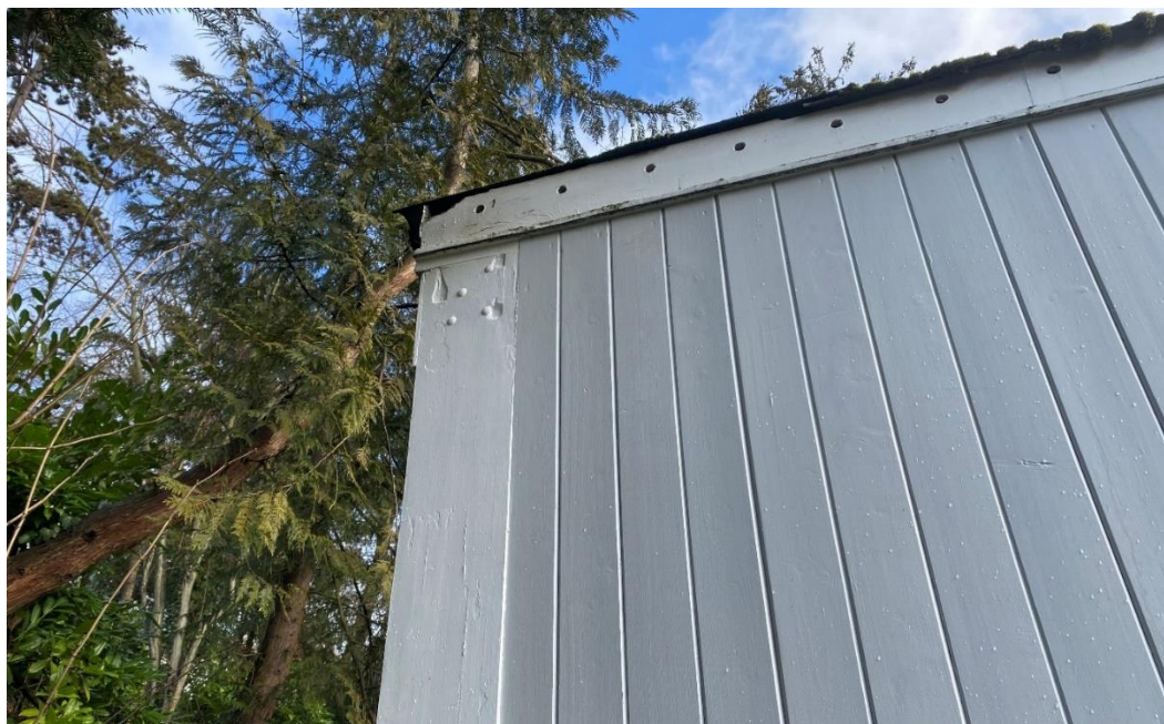
Abbildung 14: Im Zuge der Fledermauskartierung nachgewiesenes Loch zwischen Dach und Dachaufbau des Pavillons
