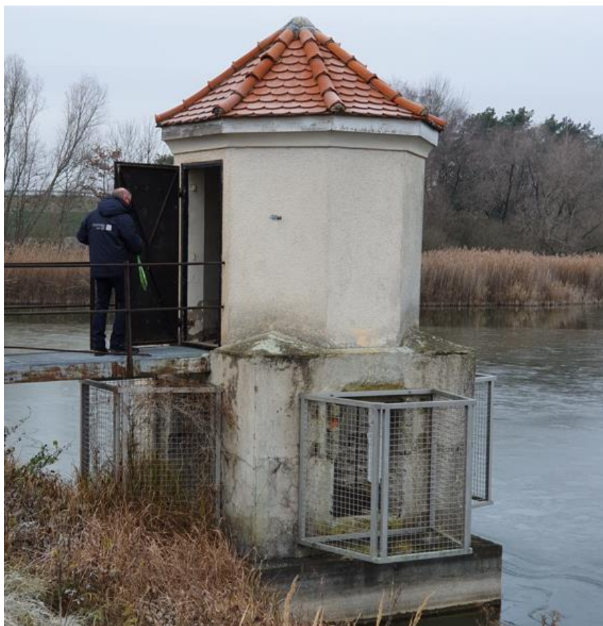
Abbildung 8: Schieberturm mit bestehender HWEA
