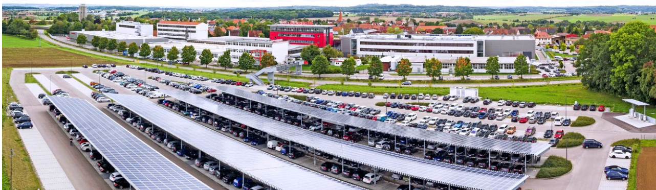
Abbildung 2: Parkplatz für Mitarbeiter*innen im Landkreis Schwäbisch Hall mit PV-Stellplatzüberdachung. Ausführung mit vier Stützen zwischen den Parkplätzen und Ausrichtung der Module in eine Richtung. Quelle: Bausch+Ströbel Maschinenfabrik
