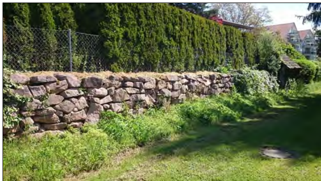
Abbildung 9: Trockenmauerabschnitt im nördlichen Plangebiet, Veränderungen in diesem Bereich sind aktuell nicht geplant
