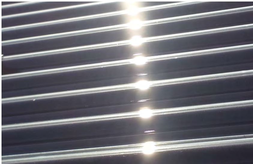
Bild 5: Nahaufnahme der reflektierenden Vakuumröhrenkollektoren der Anlage Senftenberg (Foto: H. Meseberg)
