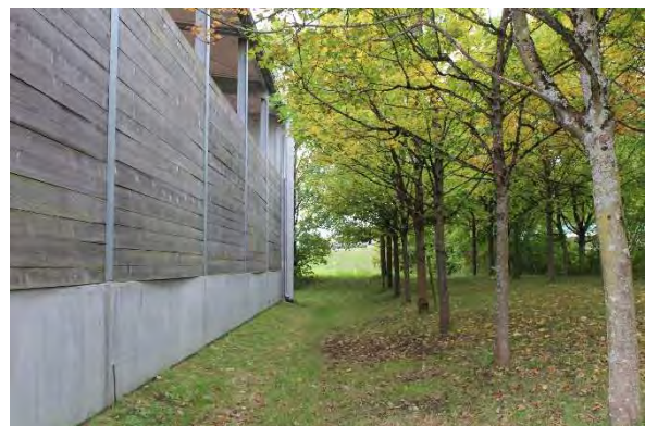
Nördliche Wand des Hackschnitzellagers mit anschließender Versickerungsmulde sowie der zweireihigen Pflanzung von Bergahornen. Der Abstand zwischen den Stämmen und dem Lager beträgt knapp 4 m.
