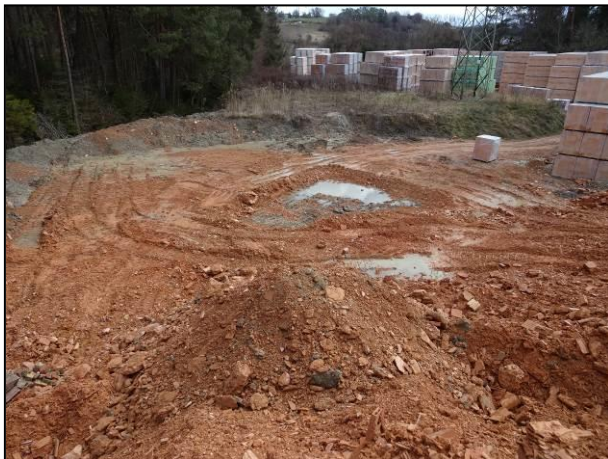
Abb. 17: Pfützenbildung innerhalb des Lagerbereichs.
