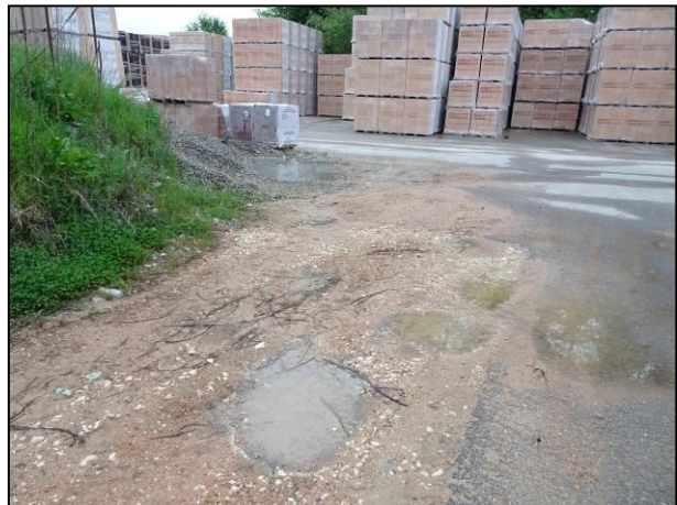
Abb. 18: Weitere Pfützen im Bereich der Zuwegungen Nähe der Ruderalfläche.
