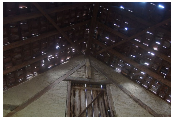
Abbildung 8: Dachstuhl des Schuppens ohne Eignung als Winterquartier und ohne Nutzungsspuren für Fledermäuse
